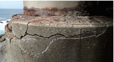
沿岸部の橋梁・港湾施設における、塩害に起因する鉄筋腐食リスクの早期スクリーニング。
